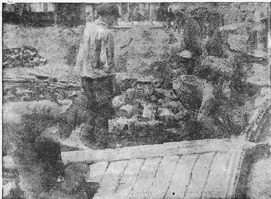
На Пушкинской площади Москвы боевыми темпами произведена замена булыжника брусчаткой и асфальтом.
